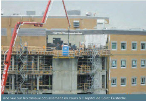
Une vue sur les travaux actuellement en cours à l'Hôpital de Saint-Eustache.
